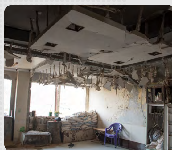
zniszczenia w jednym ze szpitali w Aleppo
